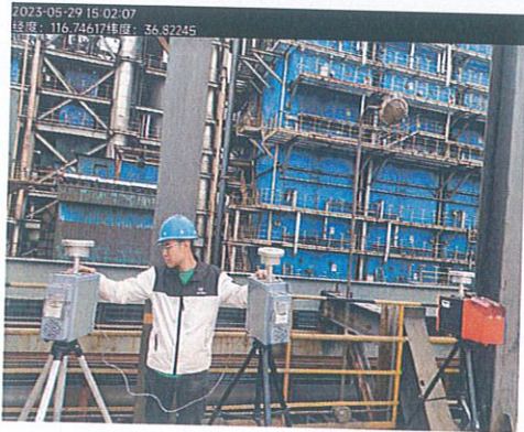
焦炉炉端焦侧的 1/3 处
